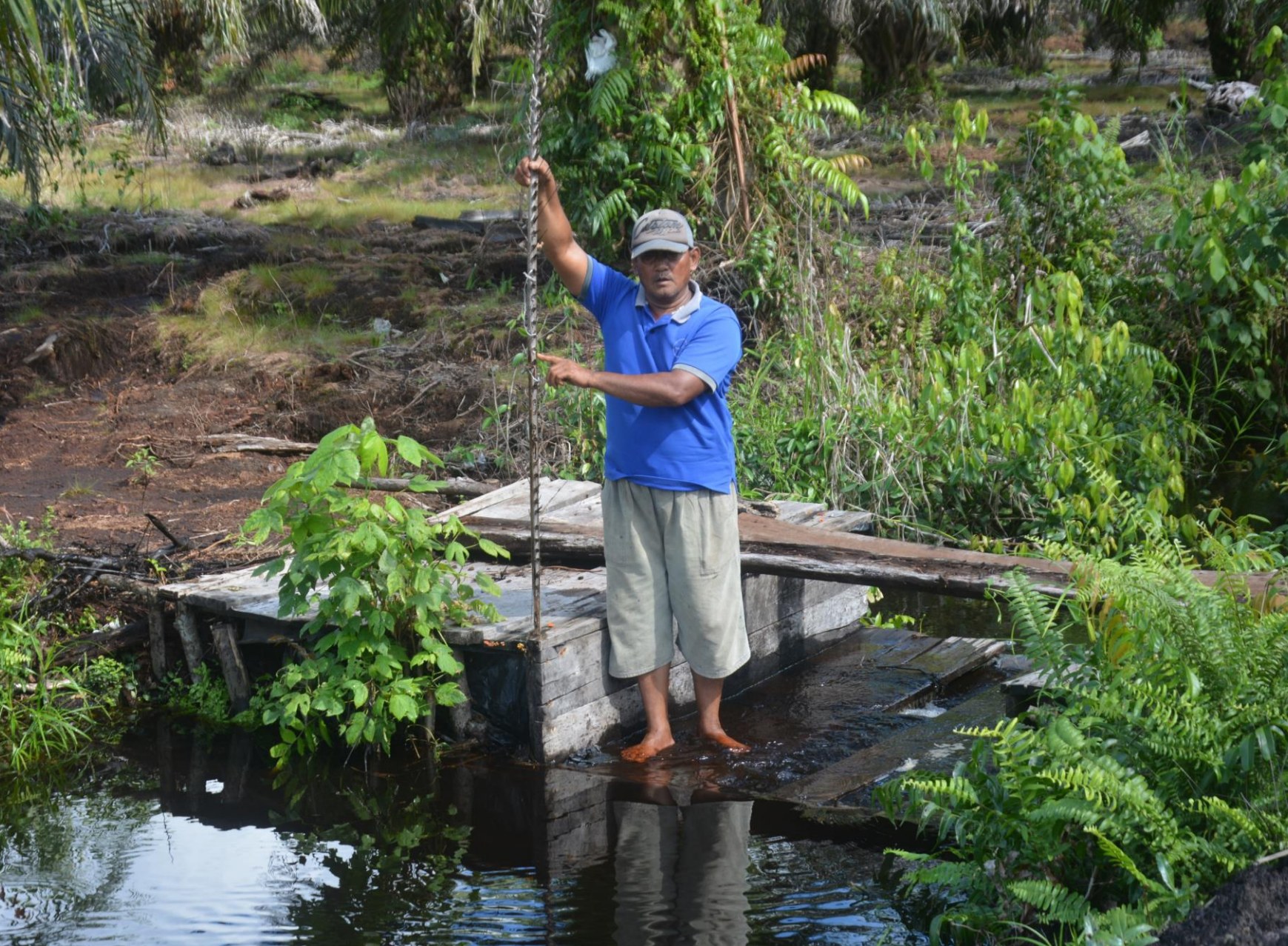
Bangunan sekat kanal, bangunan fisik tata air yang dibangun oleh Kementerian Lingkungan Hidup dan Kehutanan sejak tahun 2015 dalam upaya untuk mempertahankan tinggi muka air pada lahan gambut. Sekat kanal ini mengurangi resiko terjadinya kebakaran hutan dan lahan. Foto oleh Arfan Adhi Kurniawan
